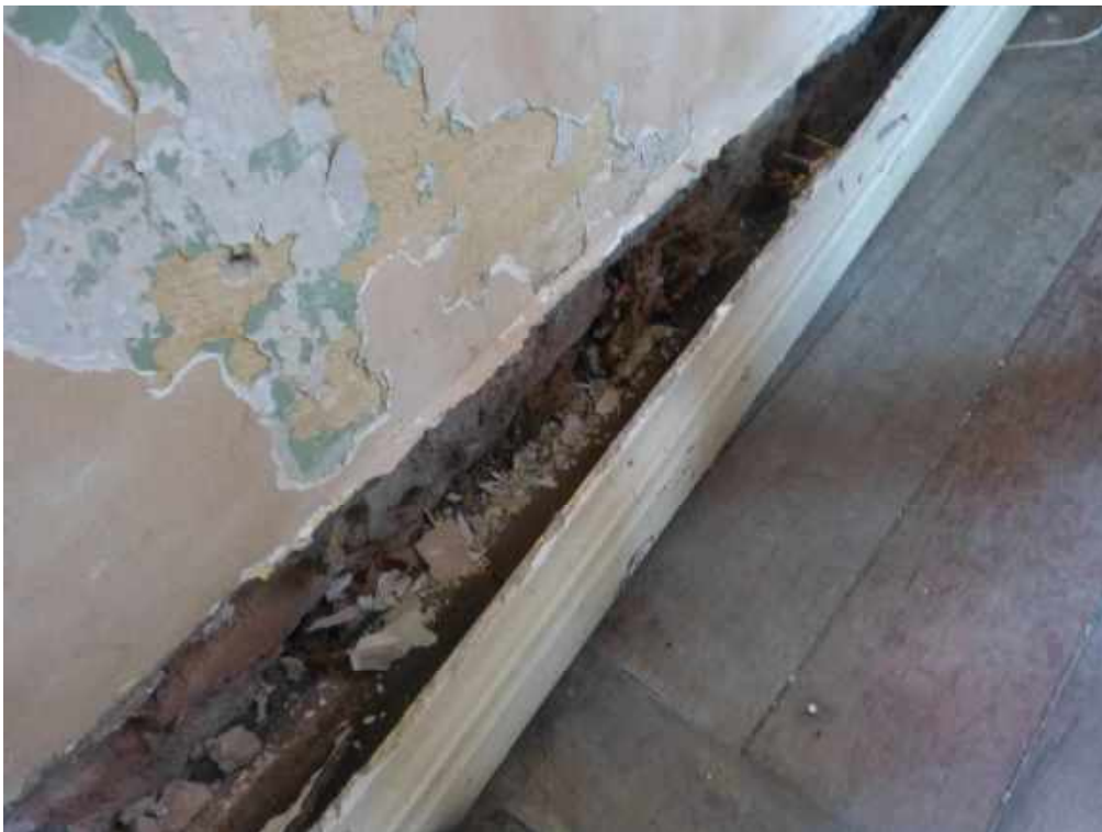
Foto 16: Sala 28 – Biblioteca – Piso e rodapés em mau estado.
