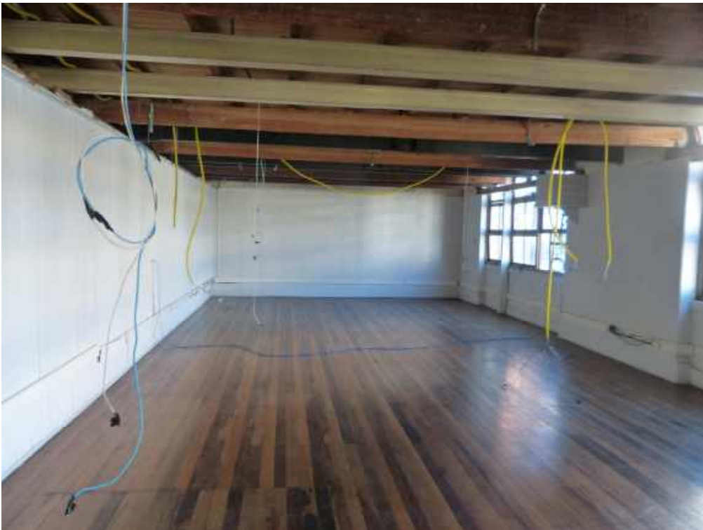
Foto 34: Salas 08 – 09 – 10 – Piso em boas condições. Toda a fiação elétrica deverá estar protegida por conduítes. Não deixar os fios elétricos soltos em cima de forro de madeira.
