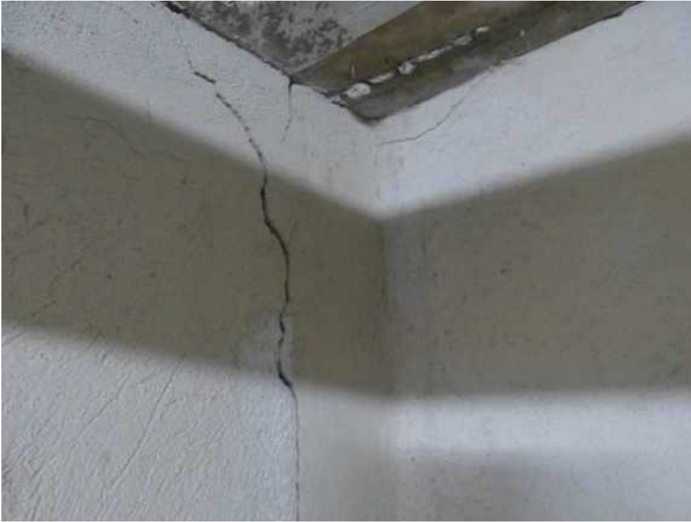
Foto 41: Sala das Caixas d'água – Trinca vertical na parede.
