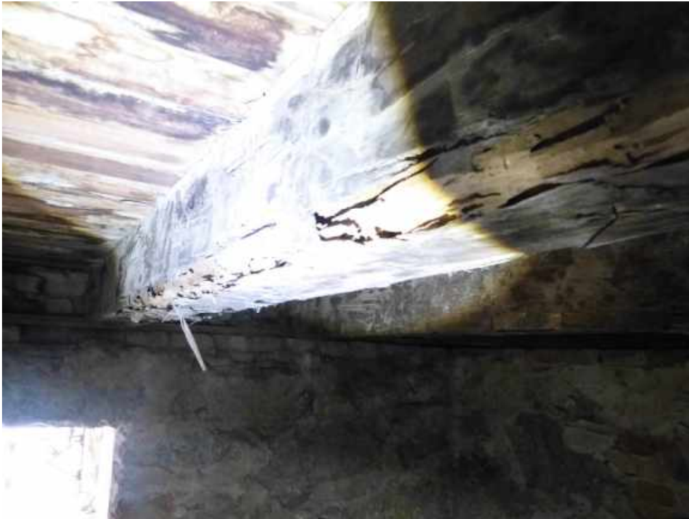
Foto 43: Vigamento de madeira com cupim na parte de baixo.
