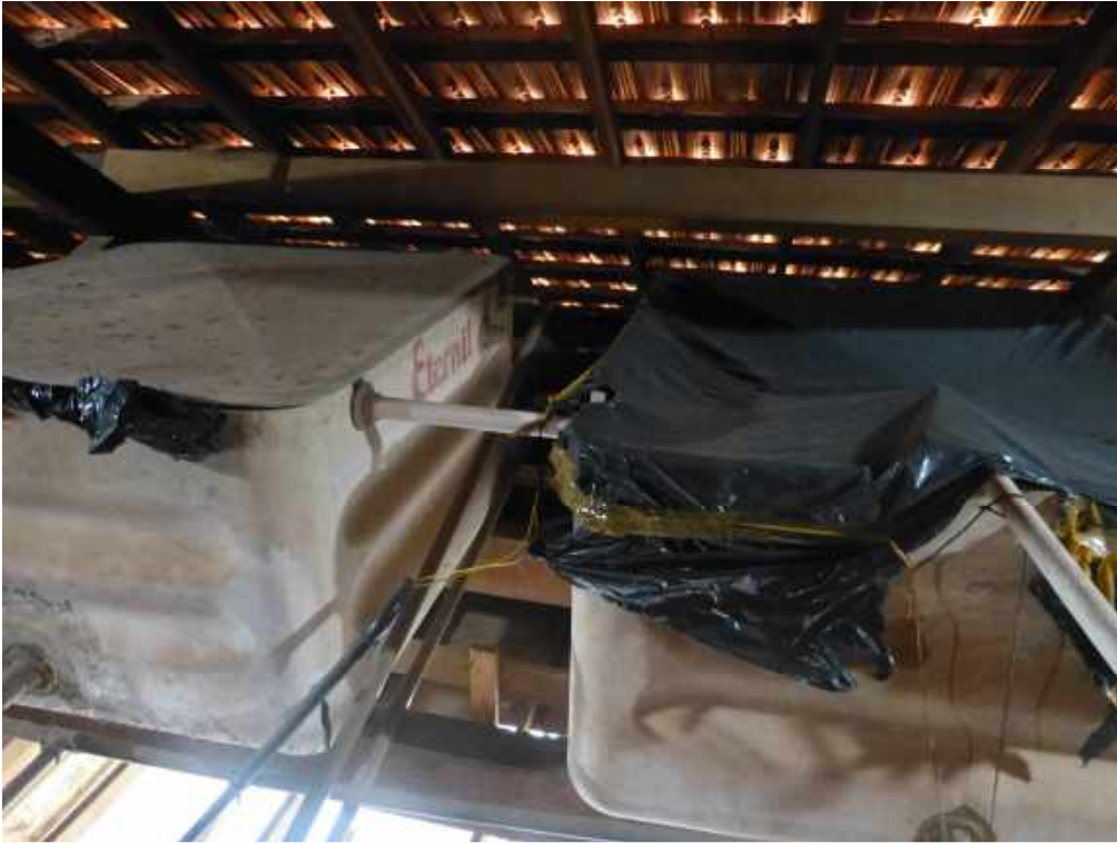
Foto 1: 2 Caixas d'água de 1000 l, no sótão, acima das salas 26 e 27.
