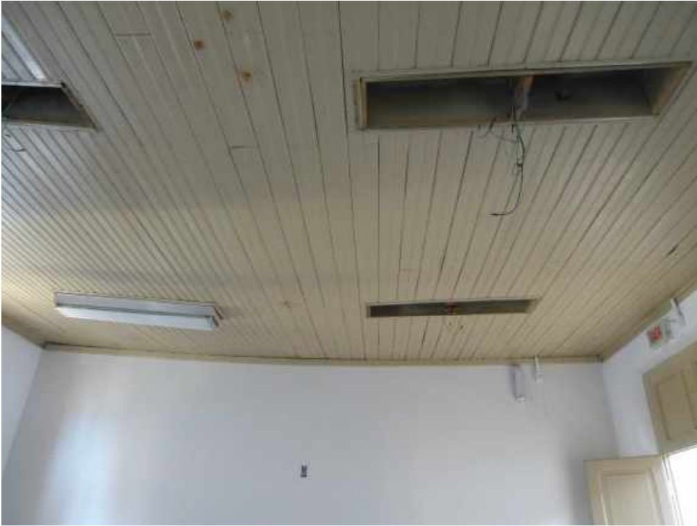
Foto 11: Sala 23 – Forro abaulado e em mau estado.
