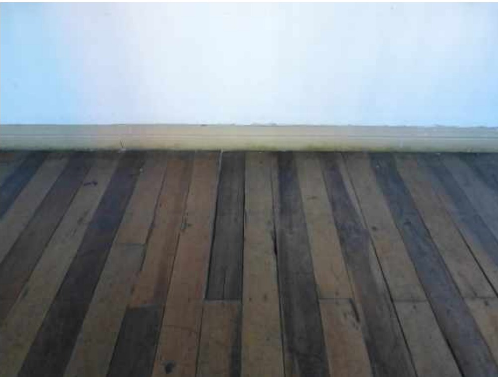
Foto 10: Sala 23 – Piso em mau estado.
