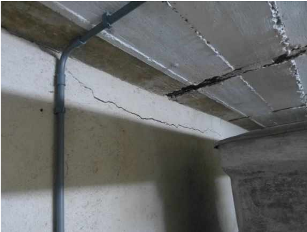
Foto 40: Sala das caixas d'água – Trinca horizontal na parte superior da parede.
