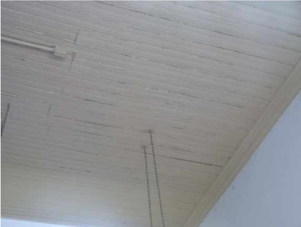
Foto 27: Sala 02 – Forro em mau estado.
