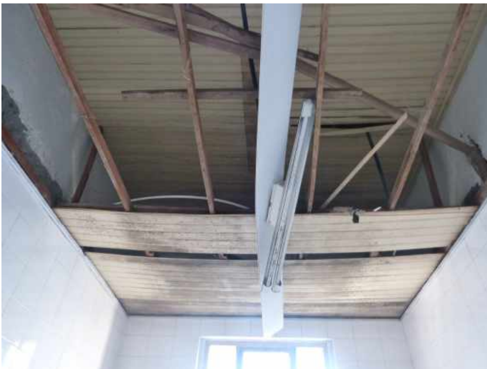
Foto 6: Sala 16 – Banheiro masculino – Forro em mau estado.
