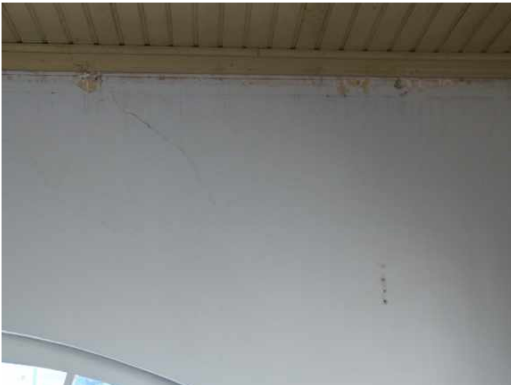
Foto 22: Sala 15 - Trinca inclinada acima do arco.
