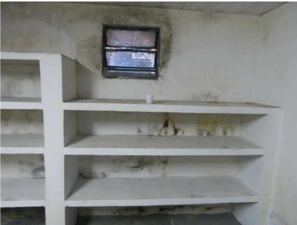
Foto 42: Parede dos armários com marcas de umidade.
