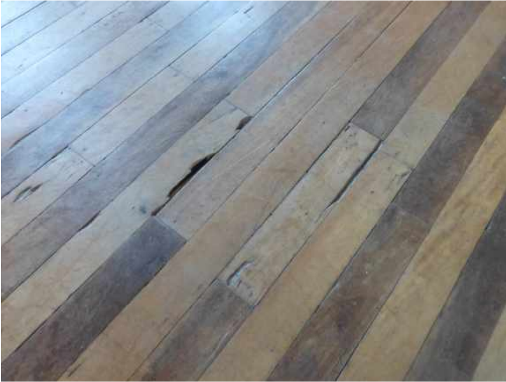
Foto 7: Sala 22 – Piso em mau estado.
