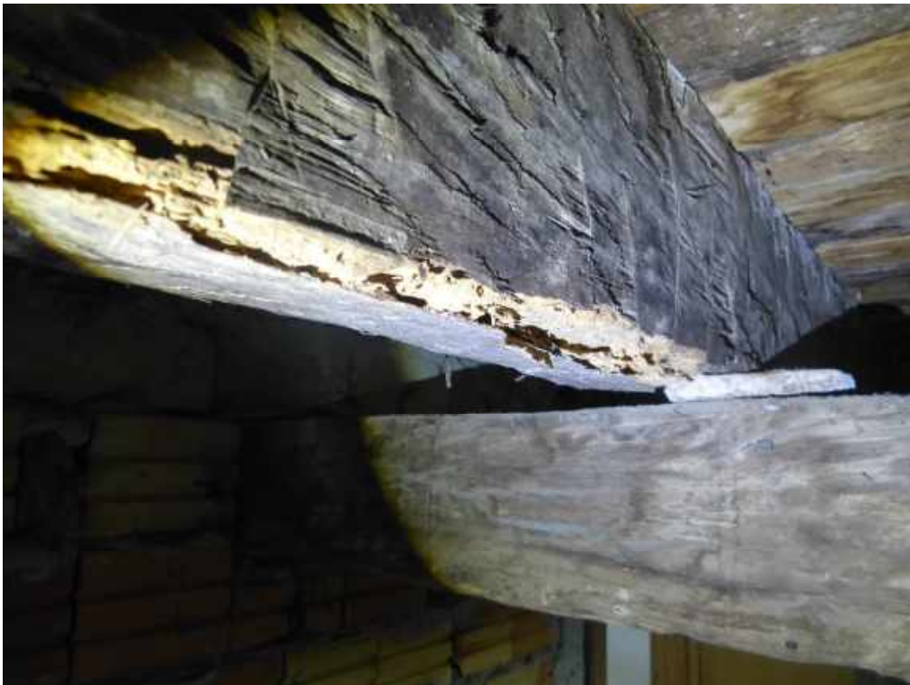
Foto 44: Vigamento em madeira com cupim na parte de baixo.
