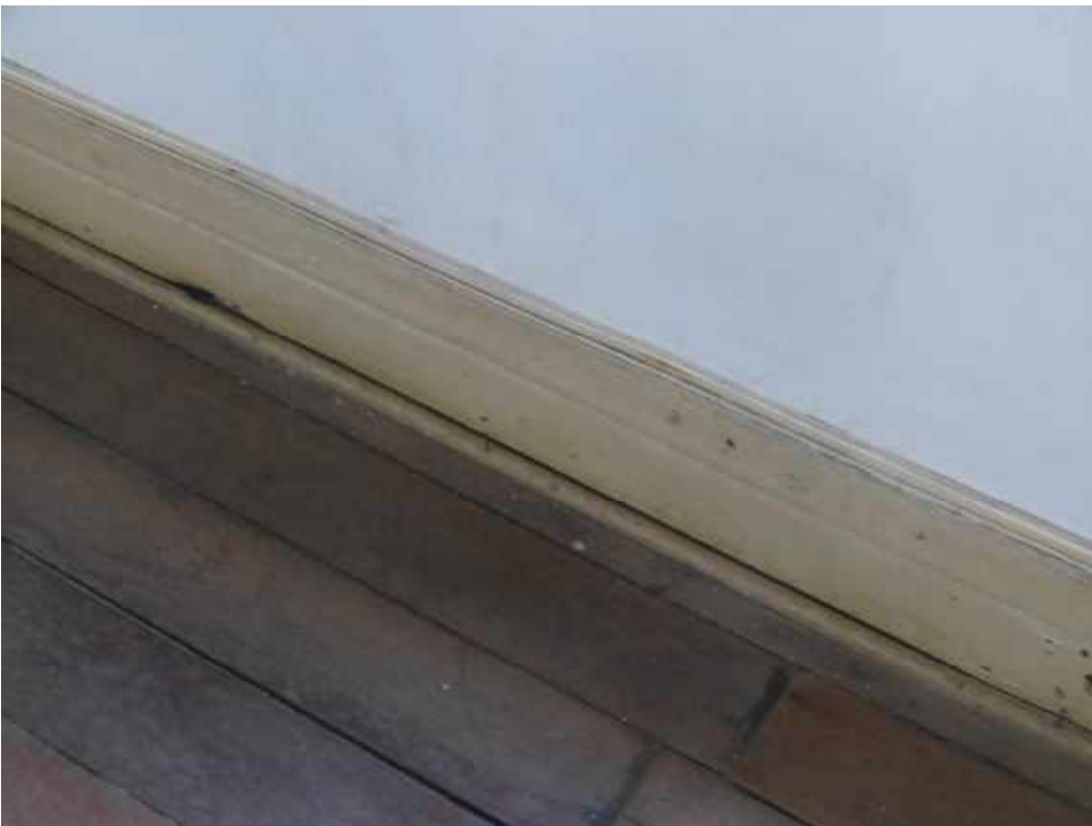
Foto 18: Sala 21 – Piso e rodapé em mau estado.
