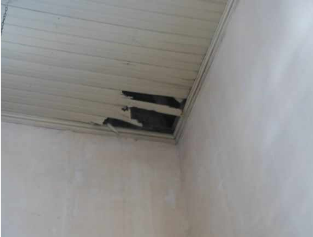
Foto 17: Sala 28 – Biblioteca – Forro em mau estado.
