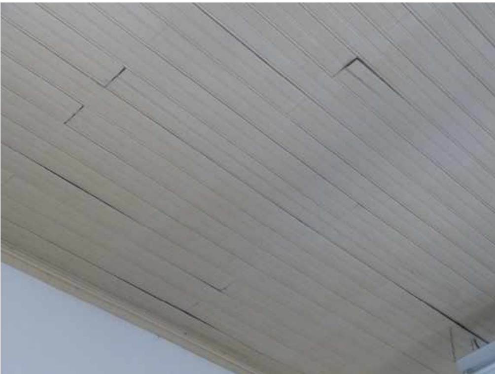
Foto 20: Salas 19 e 20 – Forro em mau estado.
