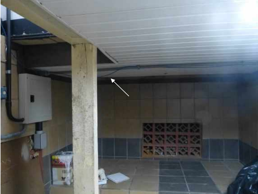
Foto 35: pilar em madeira rachado na descida da escada. Se possível, trocá-lo. Não deixar fiação elétrica solta em contato com madeira.
