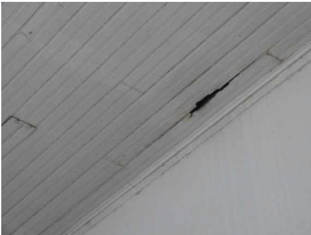
Foto 5: 2º Pavimento – Forro em mau estado.
