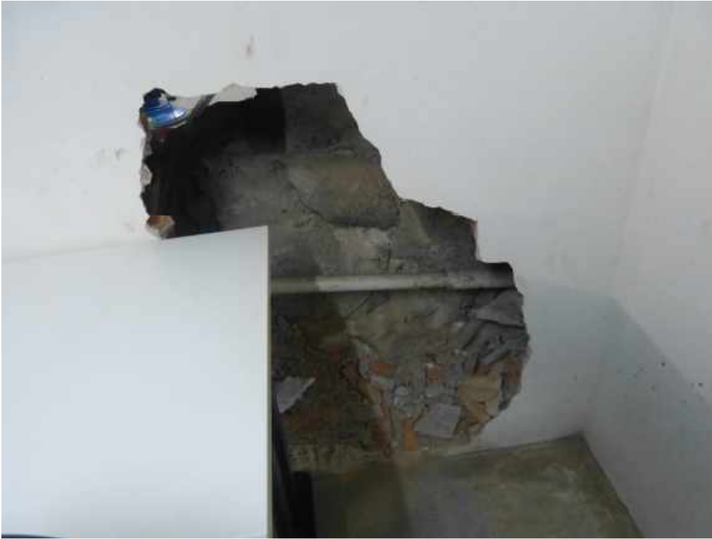
Foto 37: Sala da Engenharia – Buraco na parede.
