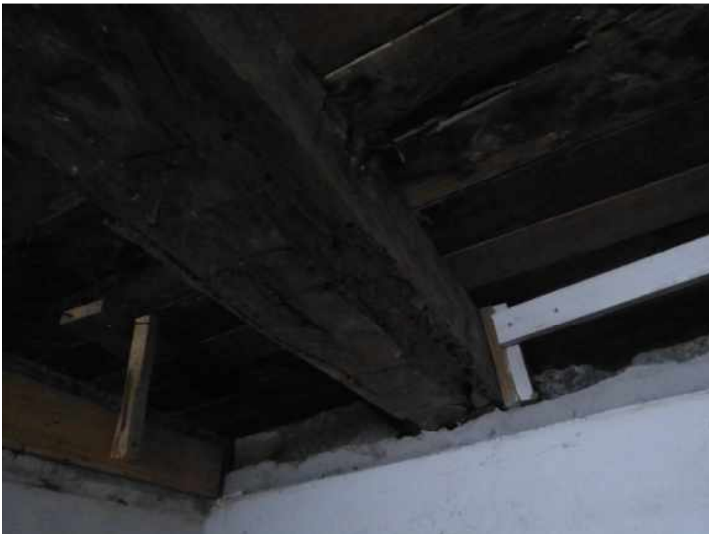
Foto 36: Barrote de madeira de sustentação do piso com cupim. Tratá-lo.
