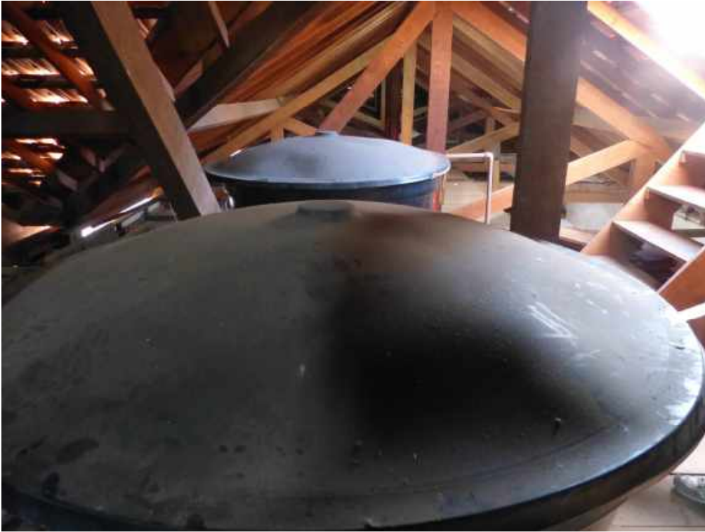
Foto 3: 2 Caixas d'água de 1000 l, no sótão, acima da sala 17.
